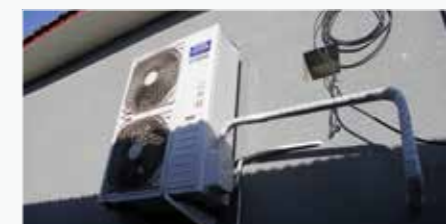
空气源热泵工程案例 北京大兴区
