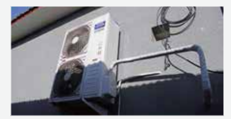
空气源热泵工程案例 北京大兴区
